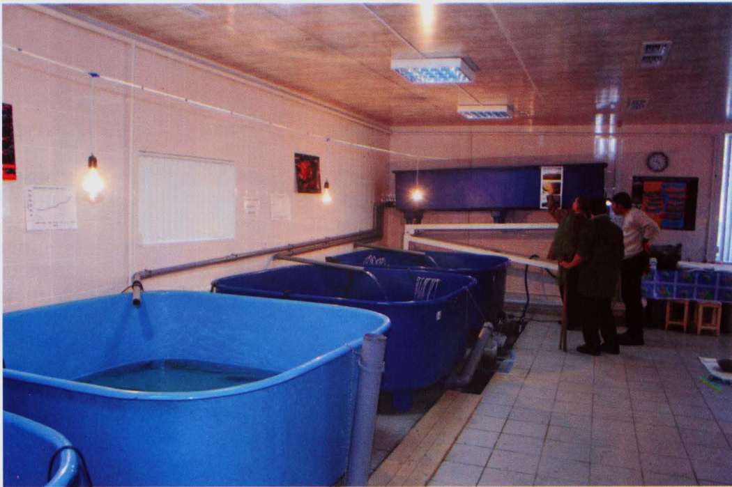
Рис. 30. Установка замкнутого водообеспечения в рыбоводном комплексе «Кагальник»
